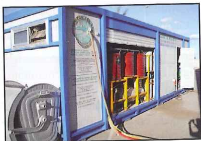
Figura 5. Planta Piloto instalada.
