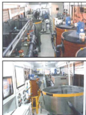
Figura 3. Dos vistas del interior de la planta piloto.
