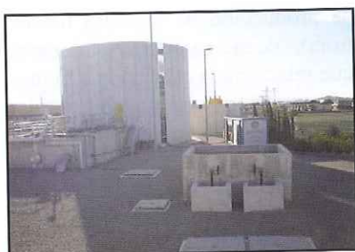
Figura 4. Planta Piloto junto al pretratamiento de la EDAR de Beniel.
